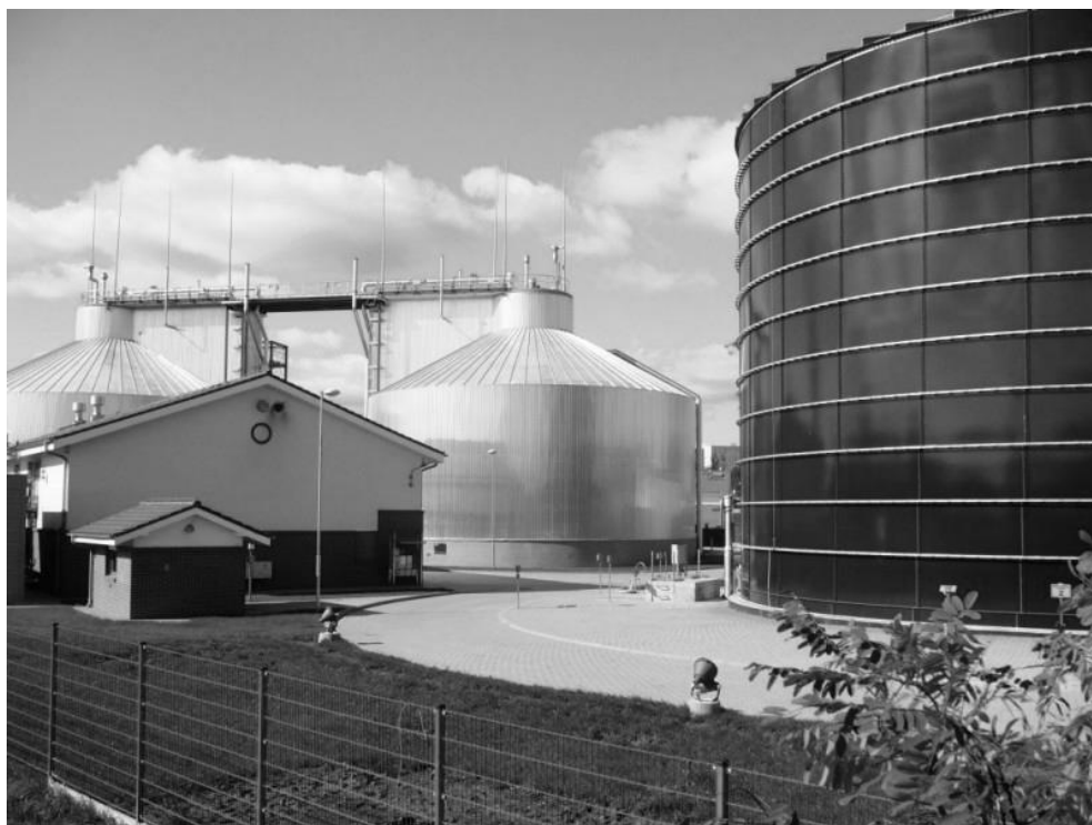
Fig. 1. Lewobrzeźna Oczyszczalnia Ścieków (Left Bank Sewage Treatment Plant) in Poznań [5]
