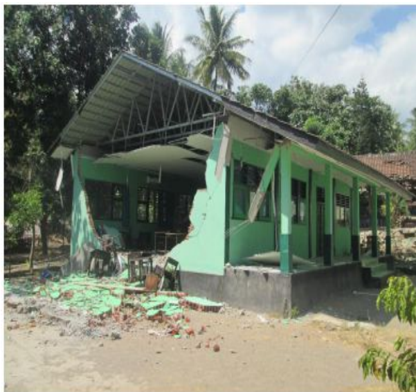
Fig. 11. The damage of of SMP N 01 Pemenang.
