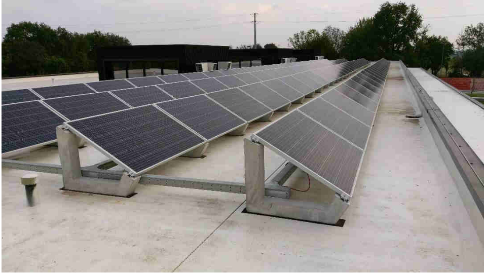
Fig. 8. 30kW PV field
