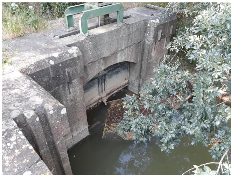
Fig. 6. Exemple de prise d'eau d'un canal agricole sur l'Aude (photo SMMAR).
