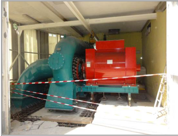
Fig. 5. Microcentrale de turbinage du nouveau débit réservé de Chaudanne.
